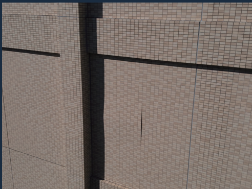
外壁タイル 浮き検出の例
